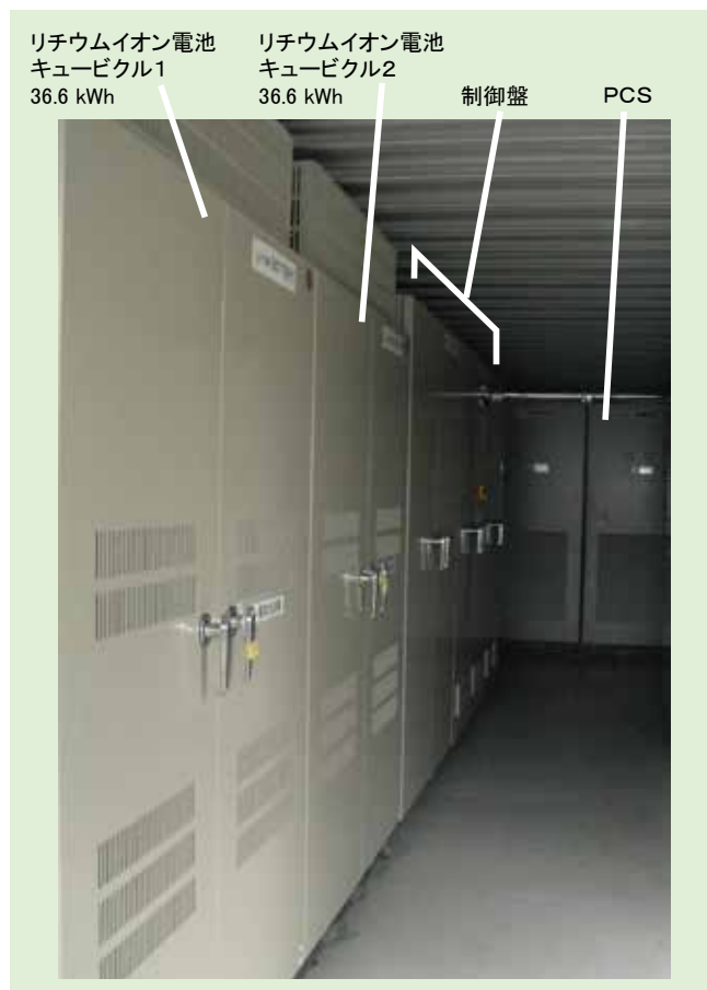
図6 リチウムイオン蓄電システム外観
