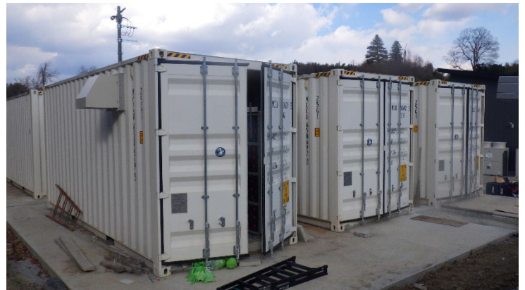
蓄電池が内蔵されたキュービクル
