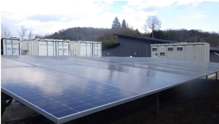
太陽光パネルとデータセンター棟
