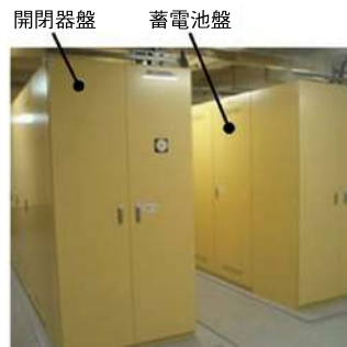
図3 納入したリチウムイオン電池システム Figure 3 Installed lithium-ion battery system
